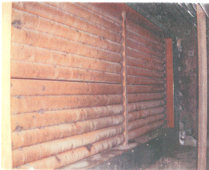
Serpentin de préchauffage
