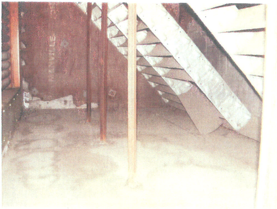
Cabinet des serpentins de préchauffage
