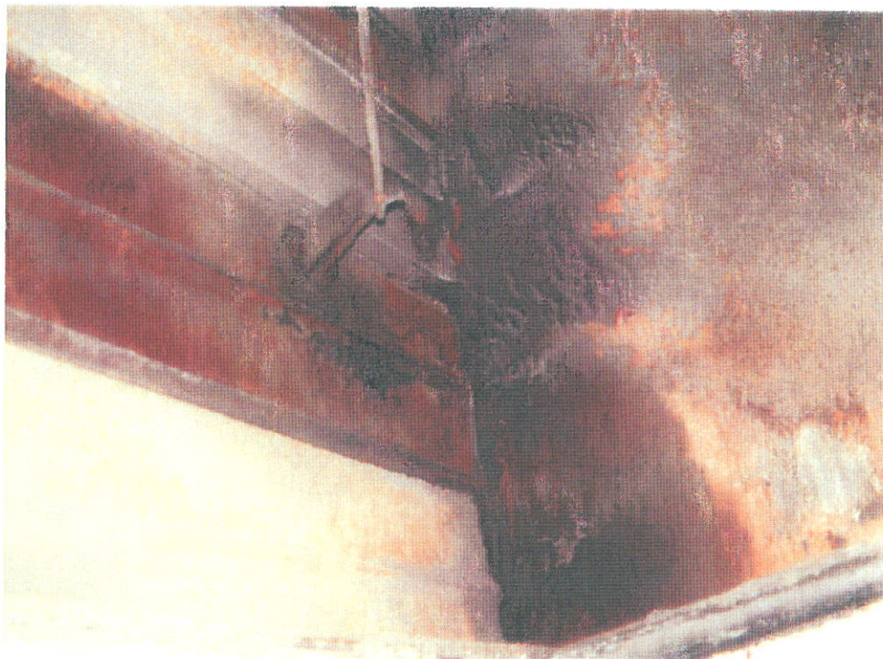
Conduit d'air frais
