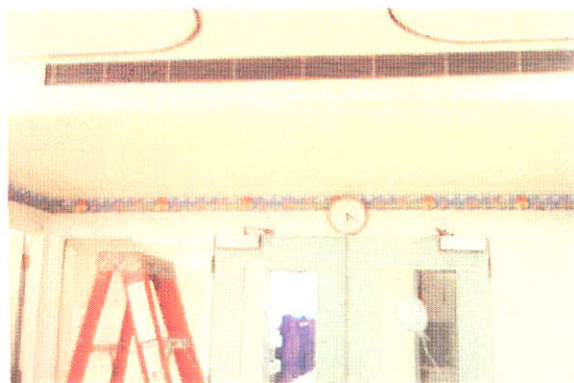
Photo 1 : Diffuseur de la salle 8 (soins intensifs).
