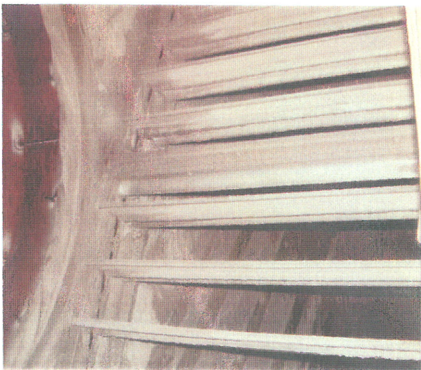
Volets du ventilateur d'évacuation
