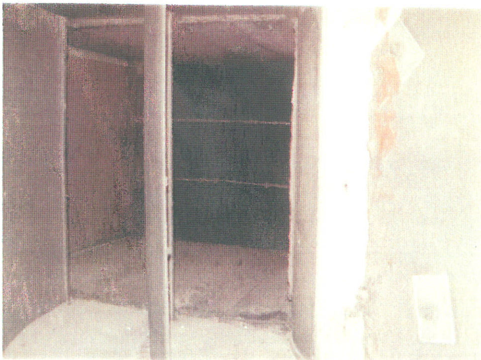
Conduit d'alimentation salle mécanique
