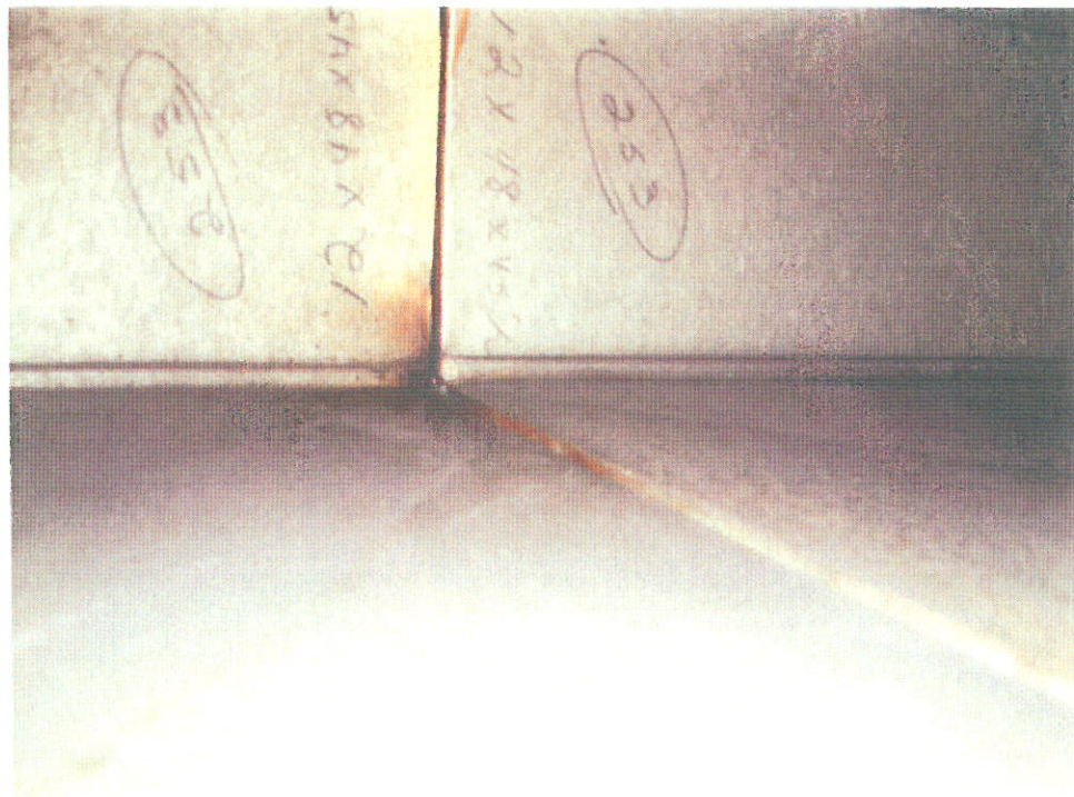
Conduit d'air frais
