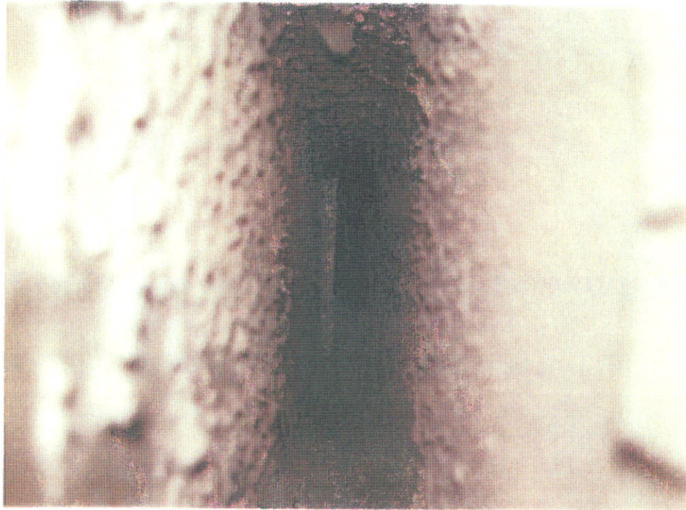
Conduit d'évacuation local 3215
